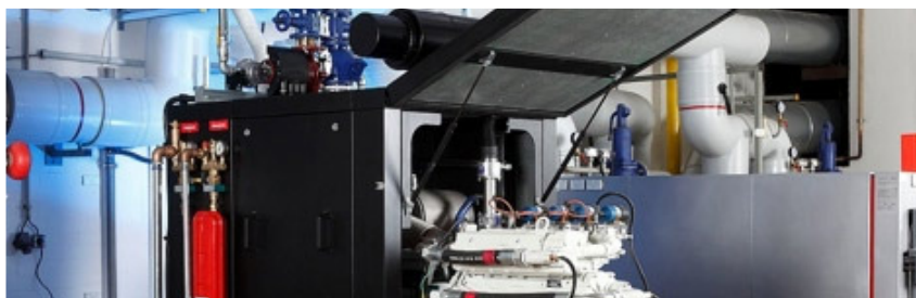
Blockheizkraftwerk; Foto: Berliner Energieagentur GmbH
